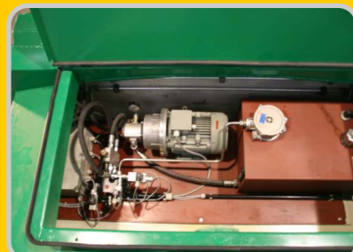
Hydraulikaggregat und Schaltschrank
