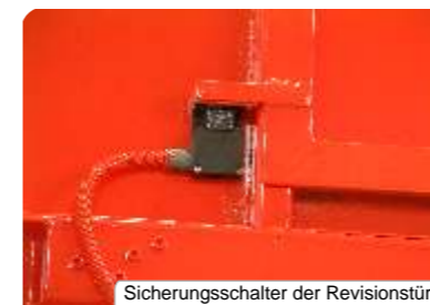
Sicherungsschalter der Revisionstür im Einfülltrichter
